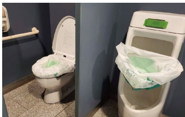
断水時に使用可能な携帯トイレの設置
